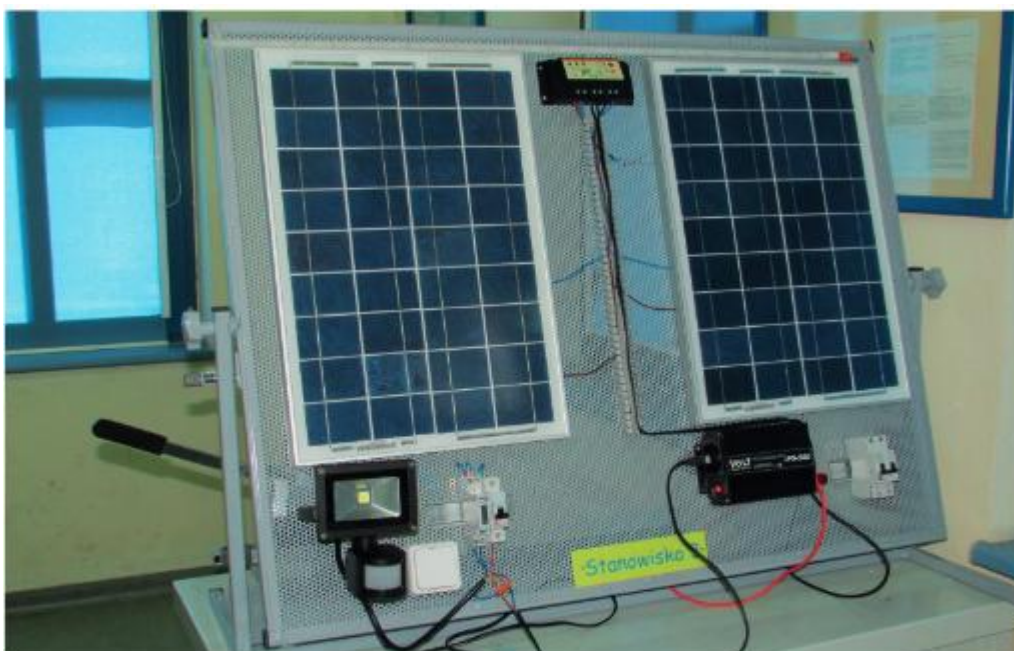
Stanowisko do montażu ogniw fotowoltaicznych w pracowni OZE
